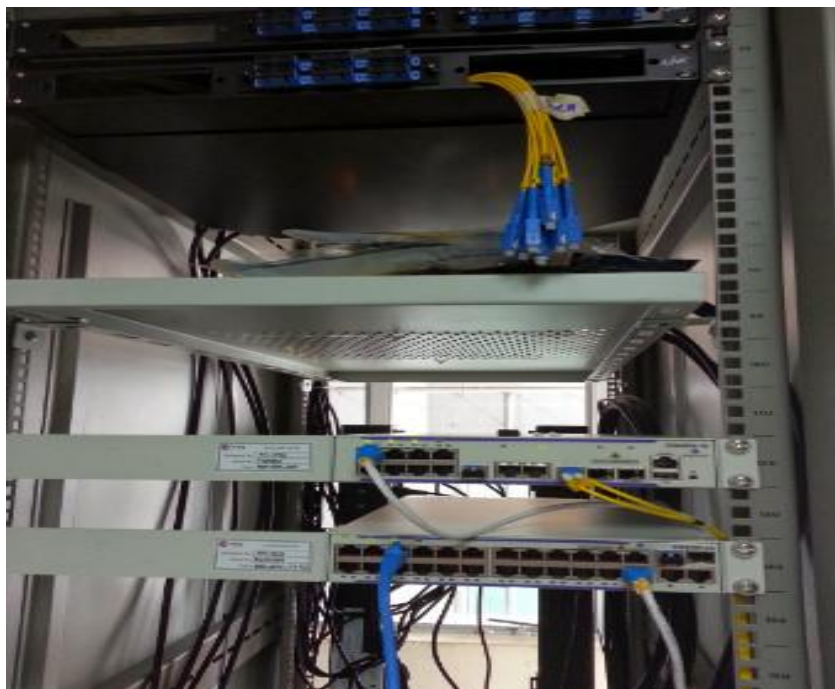
รูปที่ 10 แสดงภาพรวม แร็คเซิร์ฟเวอร์ 42U (Rack Server)ของรพ.บ้านฝื่อ
